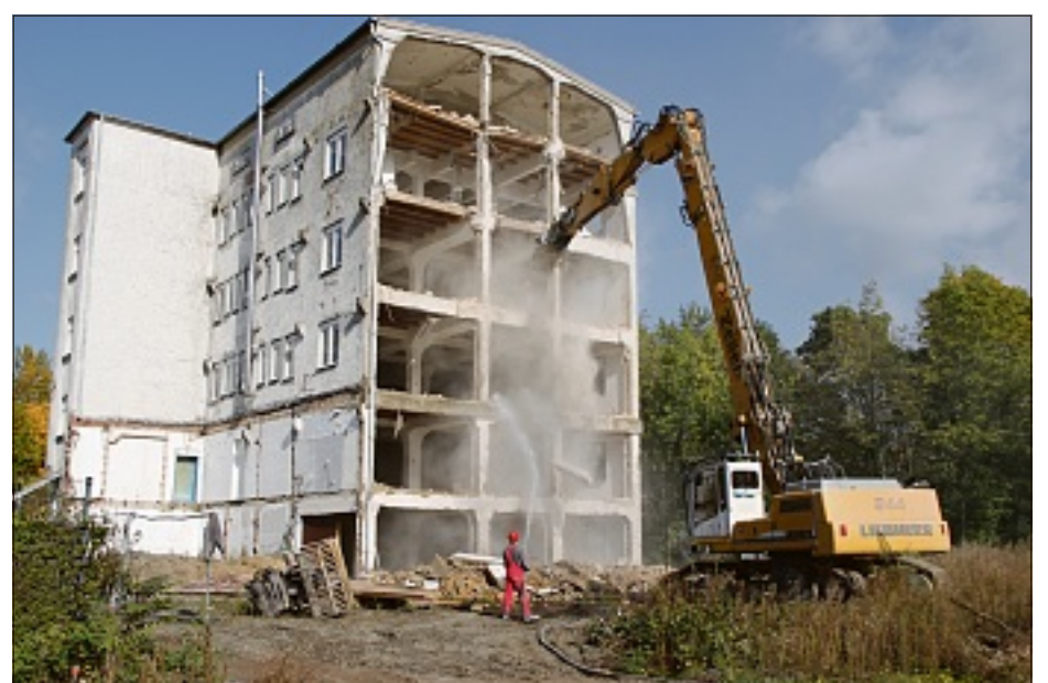
Wie das eiserne Gebiss eines Tyrannosaurus Rex beißt die Spezialzange des Abrissbaggers Stück für Stück vom erstmals markanten Gebäude der Urbansmühle ab, große Brocken fallen, viel Staub entsteht. Außer dem Baggerfahrer, der virtuos sein schweres Werkzeug in luftiger Höhe führt, ist nur noch ein weiterer Arbeiter daran beteiligt, das sechsstöckige ehemalige Betriebsgebäude dem Erdboden gleichzumachen, er versucht, mit Wasser aus einem Hydranten die Staubentwicklung einzudämmen. An der Stelle, an der das größte Gebäude der Urbansmühle bald nicht mehr stehen wird, will die Eigentümerin des Geländes, die Hattersheimer Wohnungsbau Gesellschaft, nun neue Wohnungen entstehen lassen, da sich ein Umbau des alten Baus in Loftwohnungen nicht realisieren ließ. (Foto: A. Kreuzsch)
