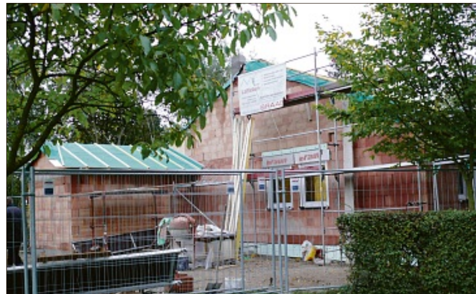
Der Neubau des Vereinshauses des ASV Hattersheim ist fast abgeschlossen, das Gebäude in Massivbauweise steht auf der Bodenplatte der durch einen Brandanschlag im März diesen Jahres völlig zerstörten Werner-Loos-Hütte. (Fotos: Schmidl)
